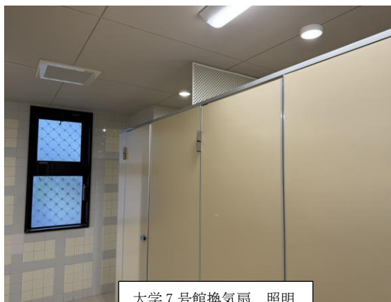
大学7号館換気扇、照明
