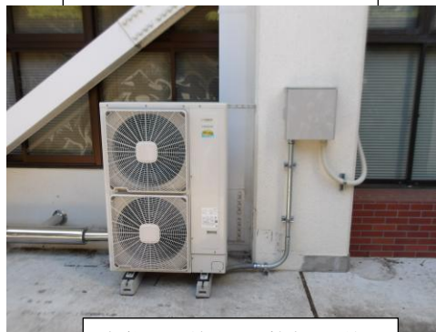
大学10号館10101教室空調機
