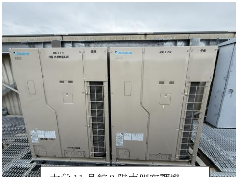
大学11号館3階南側空調機
