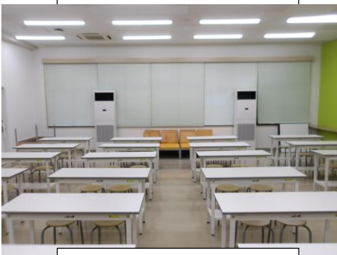
大学10号館10101教室空調機
