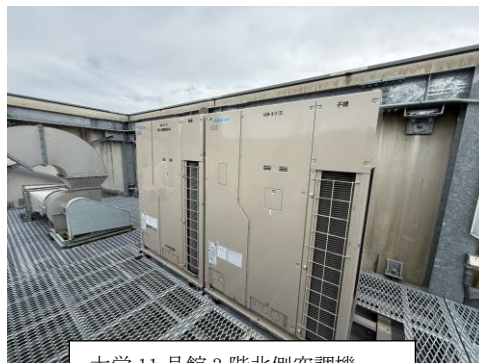
大学11号館3階北側空調機
